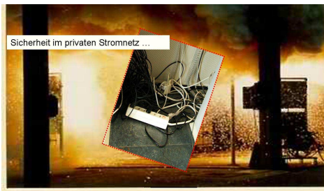
Sicherheit im privaten Stromnetz
