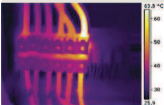
Loose Klemmenverbindung einer Reihenklemme IR Bild von BL Automation GbR
