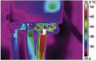
Defekte Anschlussverbindung eines NH-Trenners IR Bild von BL Automation GbR
